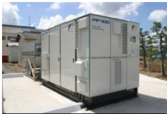
図2 100kW 燃料電池発電装置外観
