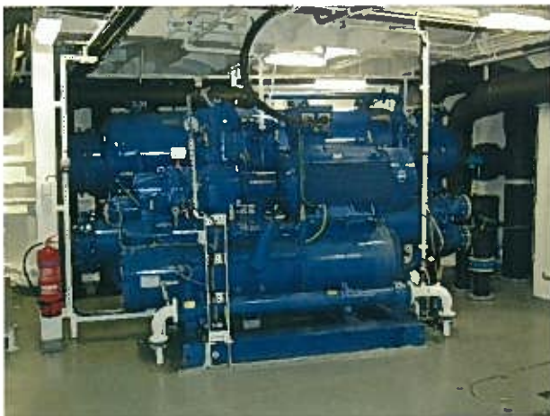
図22 冷海水用冷凍装置 (冷媒: NH3)
