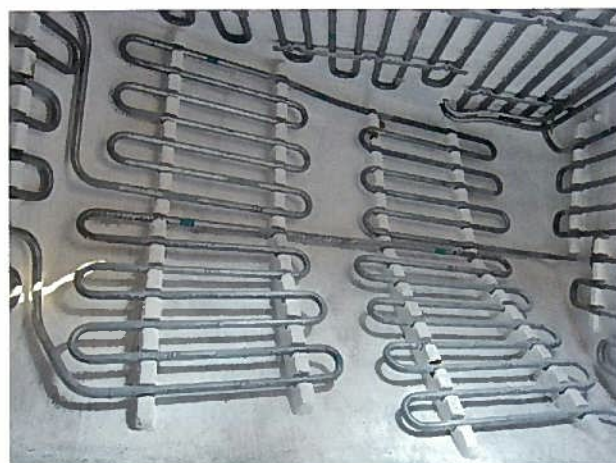
魚層内冷凍配管
