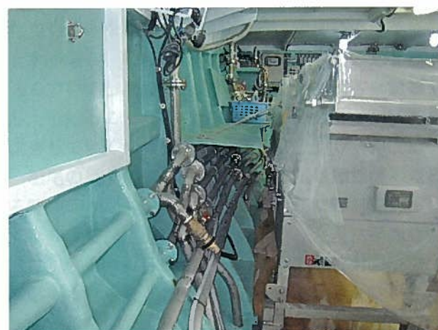
冷水配管、選別機
